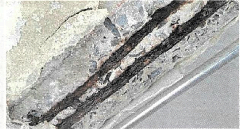
'n Voorbeeld van die ontblote ysterbewapening in 'n muur nadat die verf en pleister afsplinter het.
